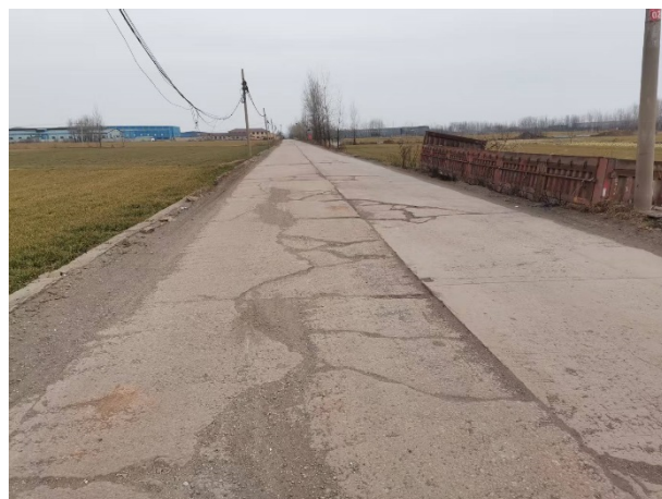
断板、沉降 (A线)
